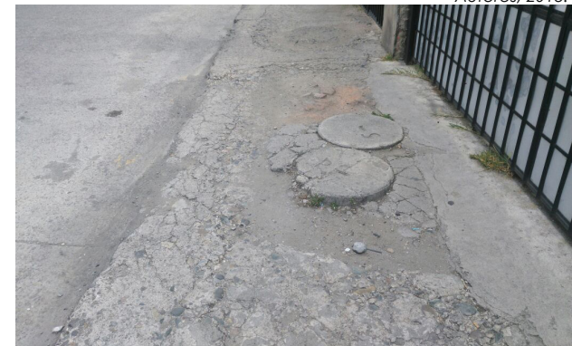
Fig 106. Acera en pésimo estado. Autores, 2018.
