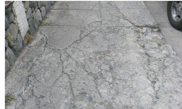
Fig 105. Acera en mal estado. Autores, 2018.
