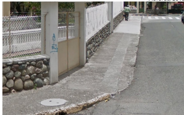
Fig 104. Acera en estado regular. Cortesia Google, 2015.
