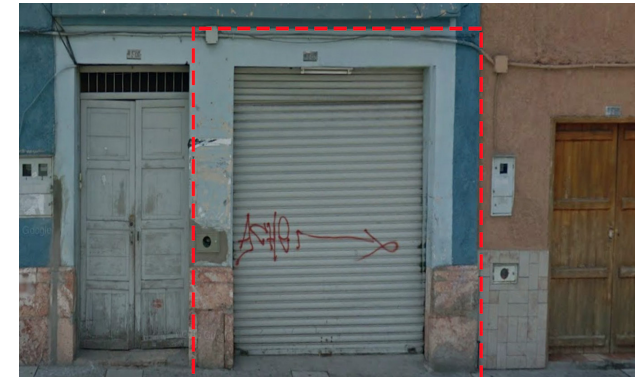
Fig 71a. Puerta vehicular en edificación sin cerramiento Cortesía Google, 2015
