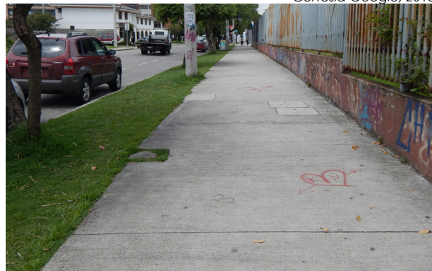
Fig 99. Acera antideslizante. Autores, 2018.
